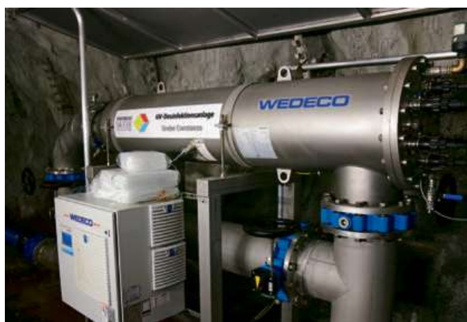
Eine moderne UV-Desinfektionsanlage sorgt für keimfreies Wasser.
