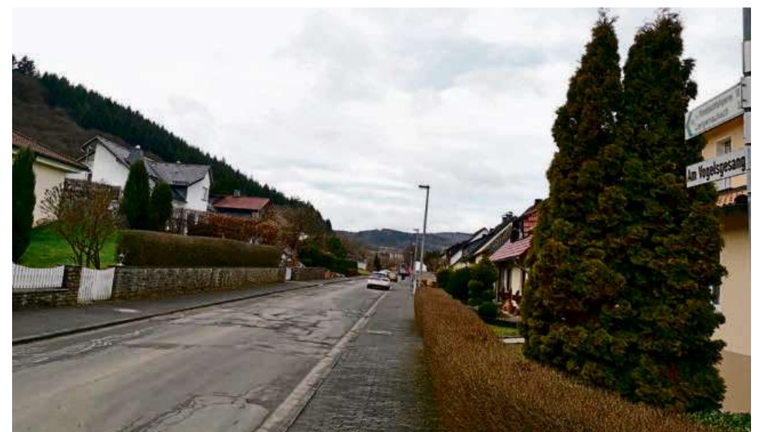
Die Straße „Am Vogelsgesang“ weist zahlreiche Schäden auf. Foto: Ralf Triesch/Stadt Haiger
