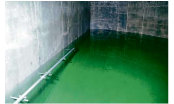
Saubere Sache: Eine der beiden Kammern des neuen Hochbehälters.
