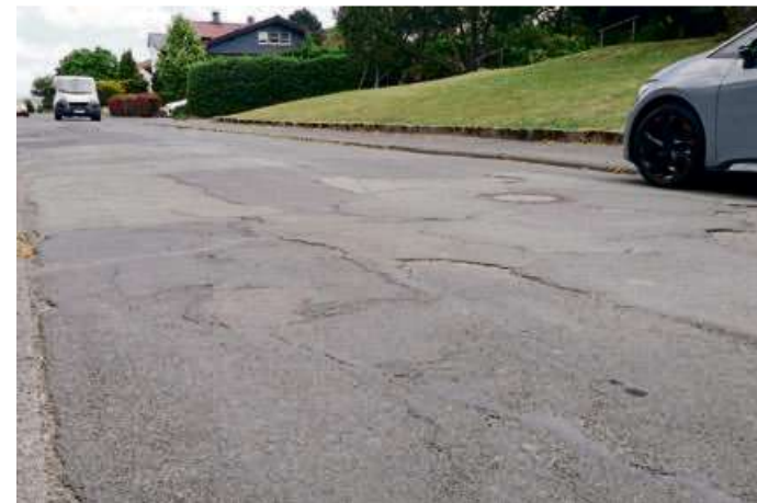
Die Straße „Vogelsgesang“ weist zahlreiche Flecken auf und muss grundhaft erneuert werden. Am Montag sollen die Arbeiten beginnen. Foto: Ralf Triesch/Stadt Haiger
