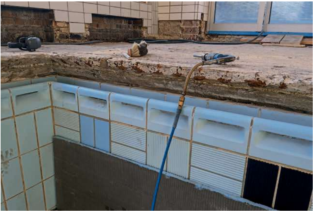
Durch die so genannte Kapillarwirkung ist Feuchtigkeit in die Bausubstanz eingedrungen – daher muss der Beton am Übergang des Beckens zum Umlauf komplett erneuert werden.
