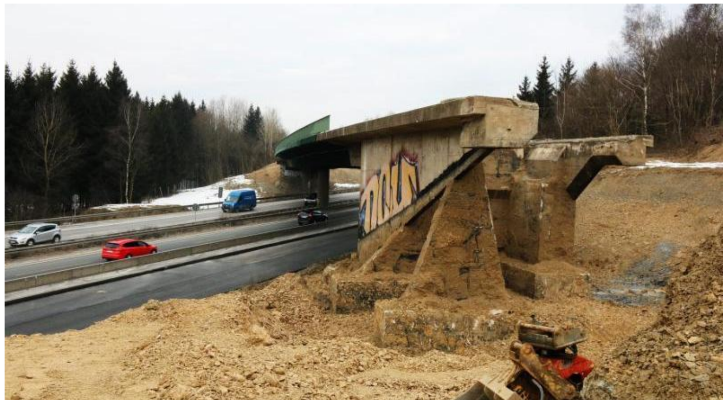
Die vorbereitenden Arbeiten sind abgeschlossen. Jetzt können die Kalteiche-Brücken über die Sauerlandlinie abgebrochen werden. Dafür ist eine Vollsperrung der Autobahn erforderlich. (Foto: Stadt Haiger)
