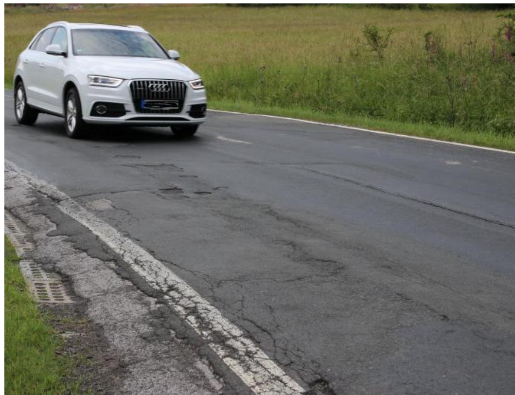
Große Teile der L 3044 sind in schlechtem Zustand. Am Dienstag rollen die Bagger an. (Foto: Stadt Haiger/Archiv)
