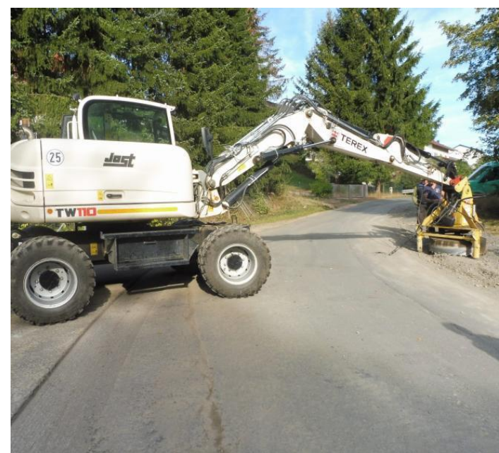
Der Verbindungsweg zwischen Steinbach und Rodenbach wird derzeit neu asphaltiert. (Foto: Stadt Haiger)
