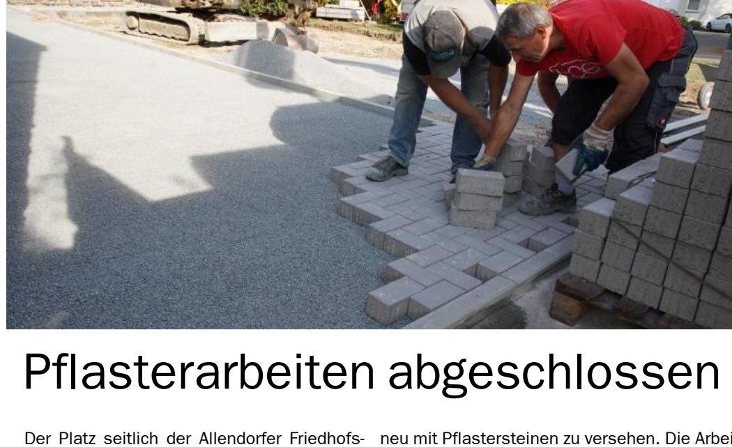
Der Platz seitlich der Allendorfer Friedhofskapelle ist neu gepflastert worden. Wie das Bauamt der Stadt mitteilte, war nach einer Ortsbesichtigung des Magistrates entschieden worden, die etwa 90 Quadratmeter große Fläche
