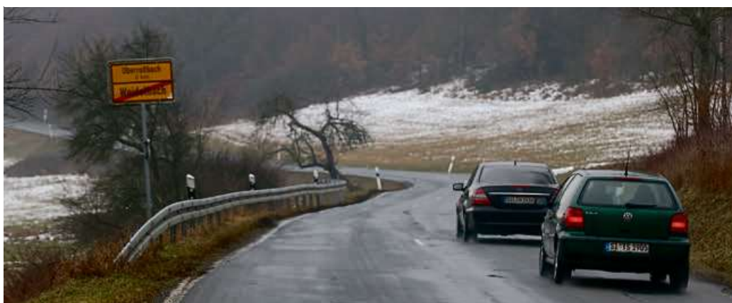
Bis zum Ortseingang von Weidelbach reicht die Baustelle. Foto: Ralf Triesch/Stadt Haiger
