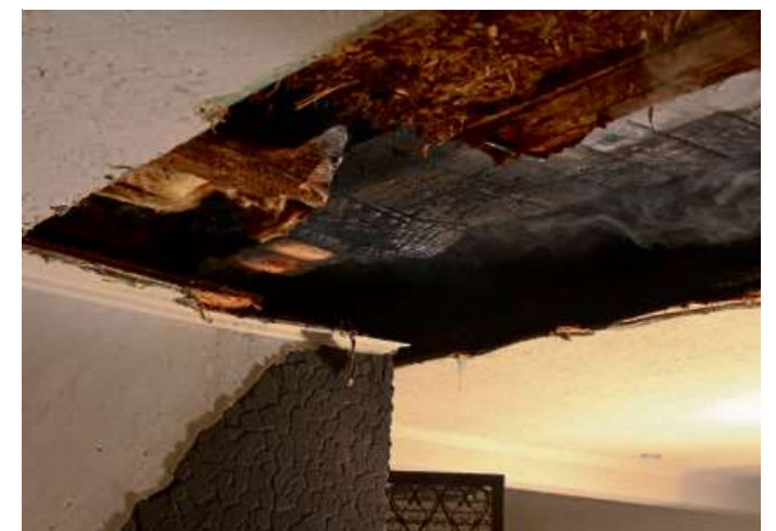
Die Flammen hatten in der Decke gewütet. Foto: Feuerwehr
