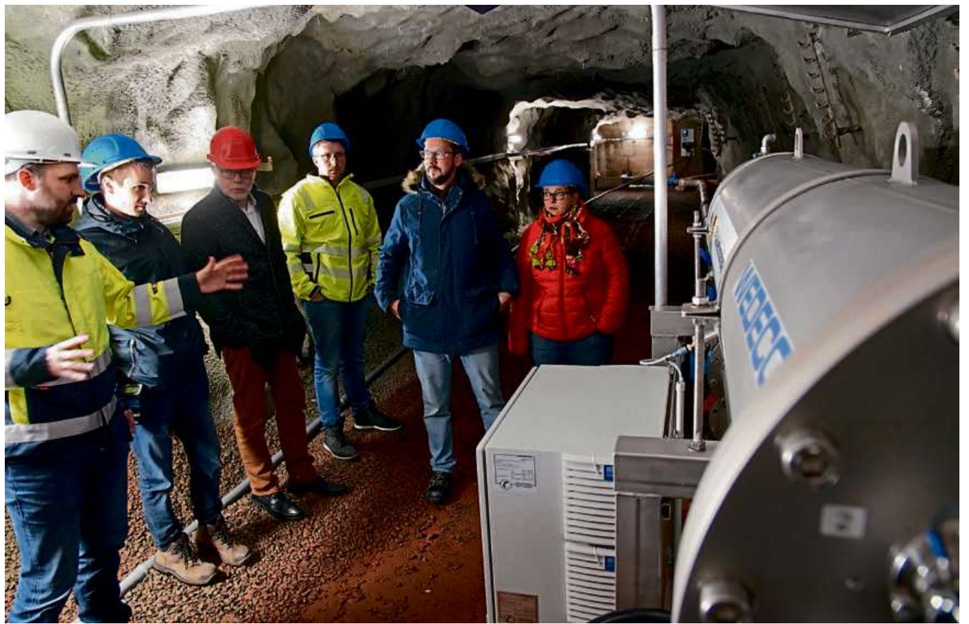
Dr. Torben Dietermann (l.) und Jacques Cantier (2.v.l.) erklären die Arbeitsweise der neuen UV-Anlage. Mit im Stollen: Bauamtsleiter André Münker Lukas Beck (Firma Kläs) sowie die Stadträte Sebastian Pulfrich und Sigrun Schmidt (v.l.). Auf dem Foto fehlen die Stadträte Herbert Fassel und Helmut Schneider. Foto: Ralf Triesch/Stadt Haiger
