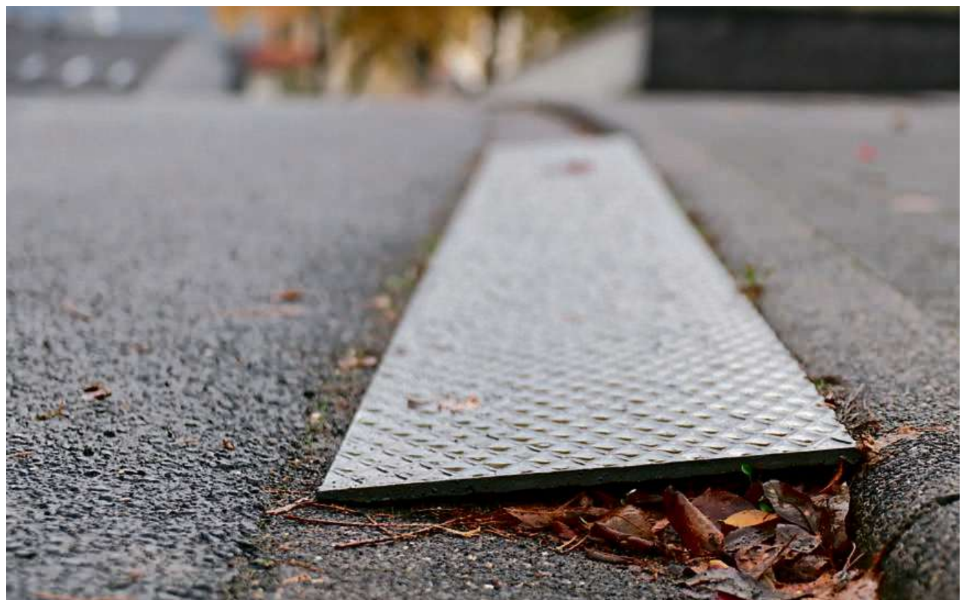
Überfahrhilfen an Bordsteinen - wie auf diesem Bild aus dem Haigerer Stadtgebiet - stellen für die Räumfahrzeuge des Winterdienstes ein Hindernis dar. Deshalb sollen sie unverzüglich entfernt werden. Foto: Lea Siebelist/Stadt Haiger
