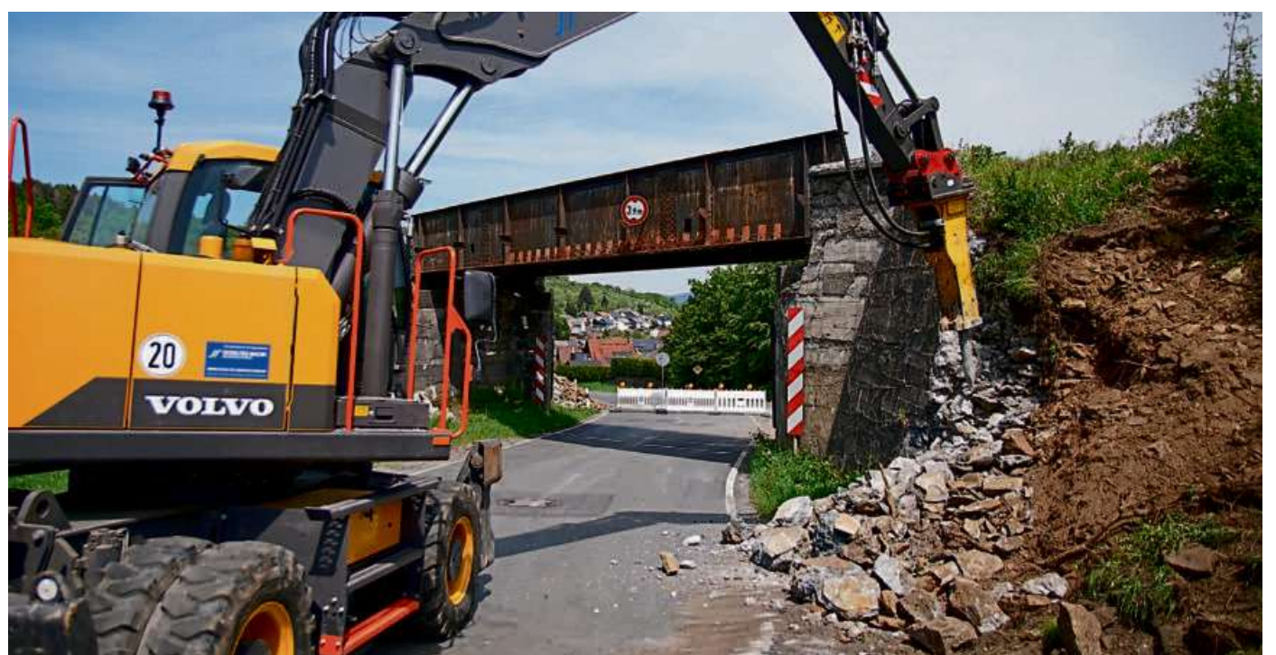
Über eine Woche dauerte es, bis die Bahnbrücke am Ortseingang von Langenaubach beseitigt war. In der Vergangenheit waren mehrfach Lkw an dem Überbau hängen geblieben. Foto: Triesch/Stadt Haiger
