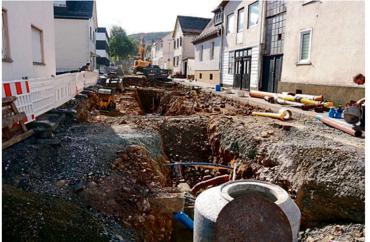
In der Unteren Pfarrstraße regieren die Baumaschinen. Die Verlegung des Kanals sollte in dieser Woche abgeschlossen werden.
