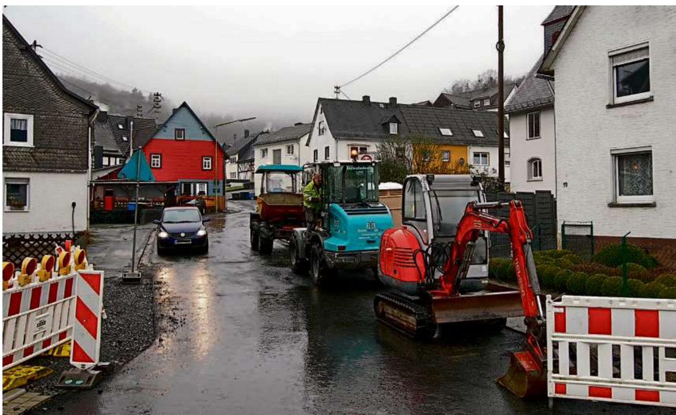
Die Baumaschinen sind bereits da - am Montag sollen die Arbeiten in der Ortsdurchfahrt in Steinbach weitergehen. Die ausführenden Firmen hoffen, dass das Wetter mitspielt. Foto: Ralf Triesch/Stadt Haiger
