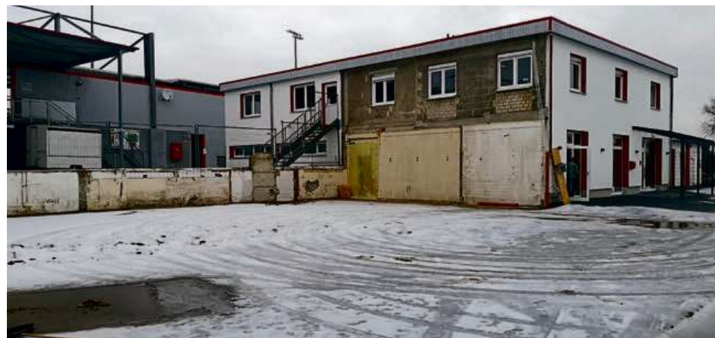
Teile des alten Sportheims am „Haarwasen“ wurden abgerissen. Foto: Ralf Triesch/Stadt Haiger
