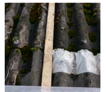
Sind asbesthaltige Wellplatten undicht, dürfen sie nicht durch eine zusätzliche Dachdeckung abgedichtet werden. Fotos: RP Gießen
