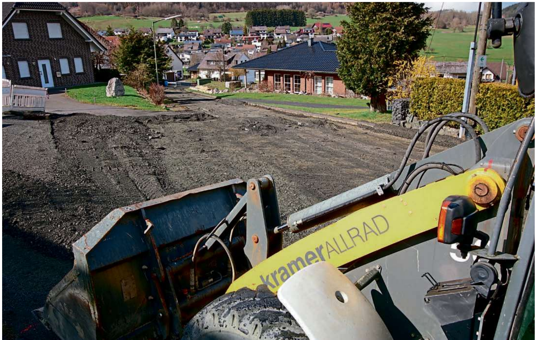
In der Straße "Im obersten Garten" in Haigerseelbach haben derzeit die Baumaschinen das Sagen.
