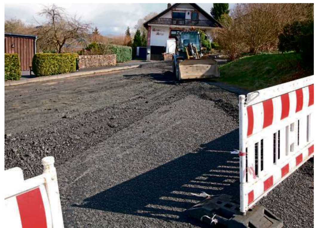
Die Arbeiten am ersten Bauabschnitt sollen im Mai abgeschlossen werden. Im Juni ist mit dem Beginn des zweiten Bauabschnitts zu rechnen.
