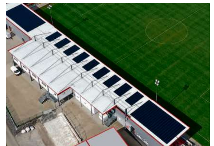
Luftbildaufnahme der neu installierten Photovoltaik-Anlage auf dem Dach der Haupttribüne am Haarwasen in Haiger. Foto: TSV Steinbach Haiger
