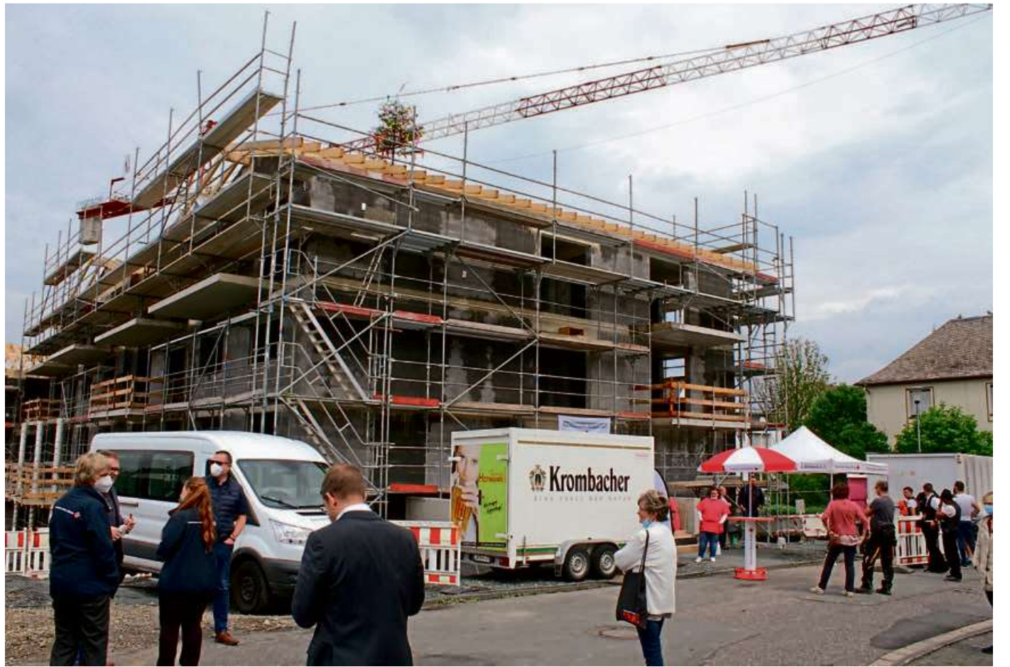
Am neuen „DRK-Seniorenzentrum Haiger“ in der Schlesischen Straße wurde Richtfest gefeiert. Kurz nach dem Hessest soll das Gebäude fertig sein. Foto: Bretsch/DRK
