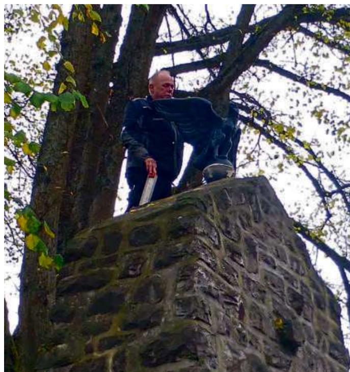
Harald Gilbert vom Offdillner Heimat- und Geschichtsverein reparierte und montierte den Adler. Foto: Harro Schäfer
