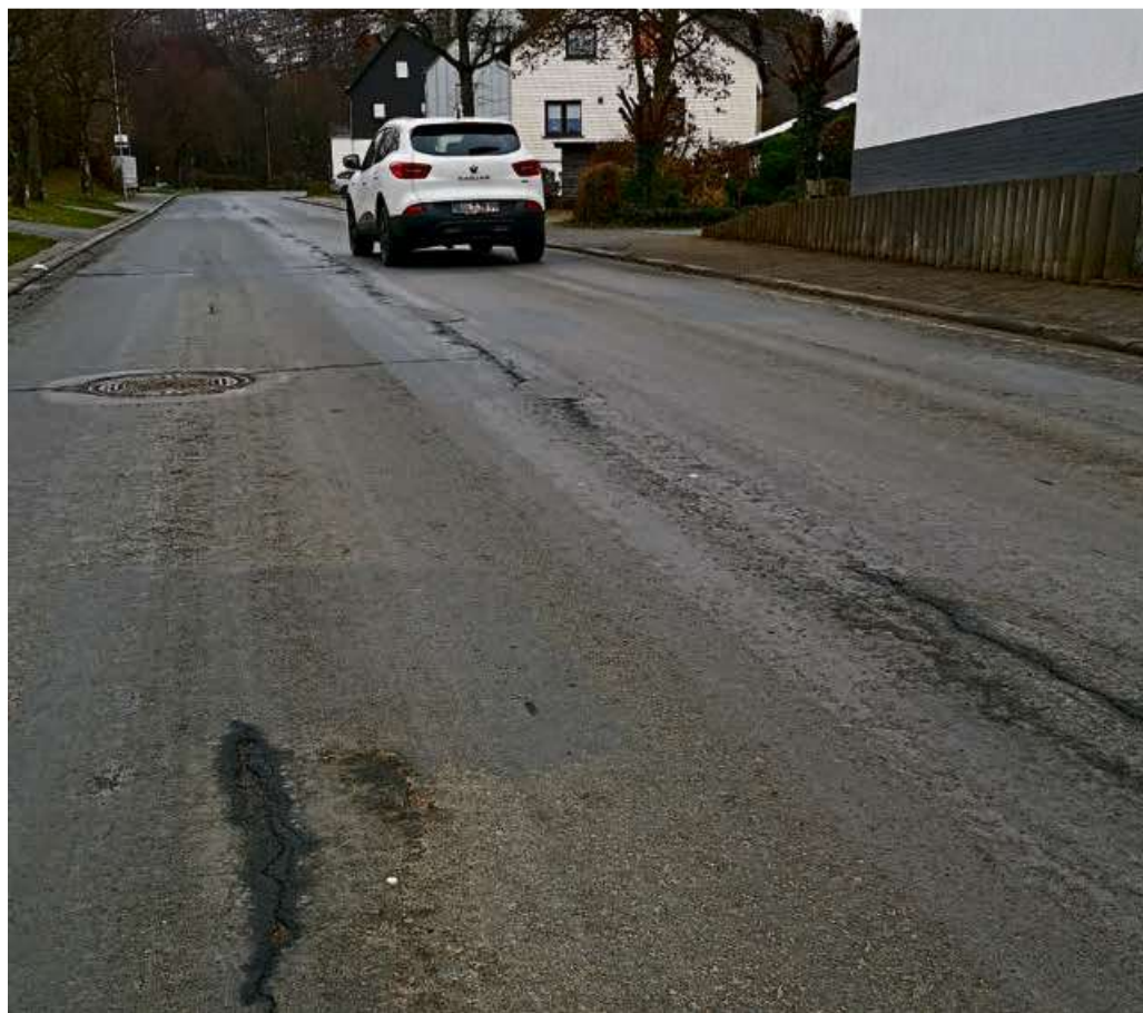
Die Ortsdurchfahrt in Weidelbach muss saniert werden. Wenn alles funktioniert, können die Arbeiten, die in fünf Teilabschnitte eingeteilt wurden, im Sommer beginnen.
