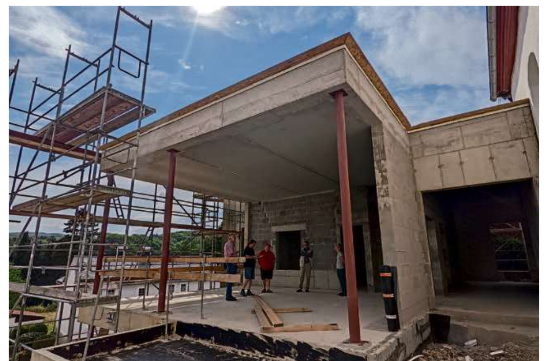
Der Rohbau des Gemeindezentrums neben der Allendorfer Kirche ist fertig: Links der Multifunktionsraum mit Außenfläche, rechts der neue Eingang in die Kirche. Foto: Walter Lutz
