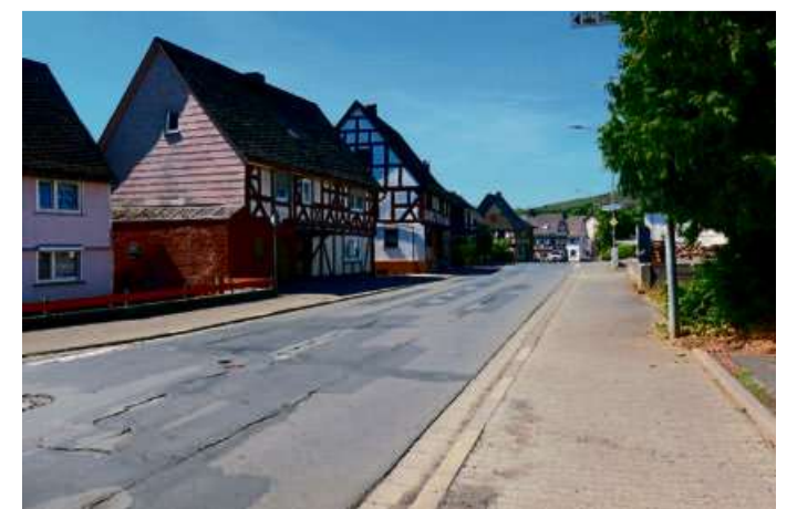
Die Weidelbacher Ortsdurchfahrt weist zahlreiche Schäden auf. Deshalb wird sie jetzt auf insgesamt 800 Metern saniert.
