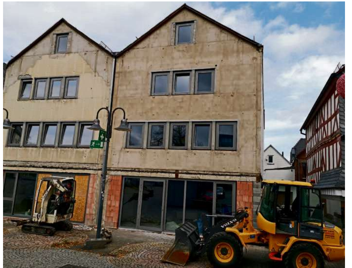
Das Stadthaus in Haiger (Haus Ehe) wird derzeit umgebaut. Hier sollen die Haigerer Stadtbibliothek sowie die Tourist-Info untergebracht werden. Foto: Ralf Triesch/Stadt Haiger
