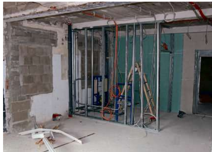
Im Haus Ehe finden umfangreiche Sanierungsarbeiten statt. Zudem muss ein Aufzug installiert werden, um das Gebäude barrierefrei erreichbar zu machen. Foto: Ralf Triesch/Stadt Haiger
